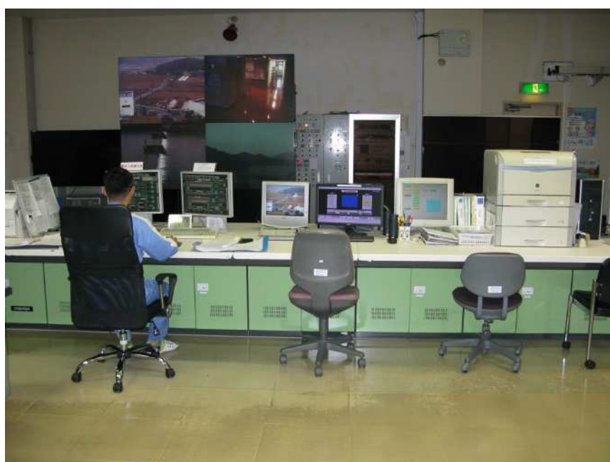
<多礼浄水場 中央管理室>
