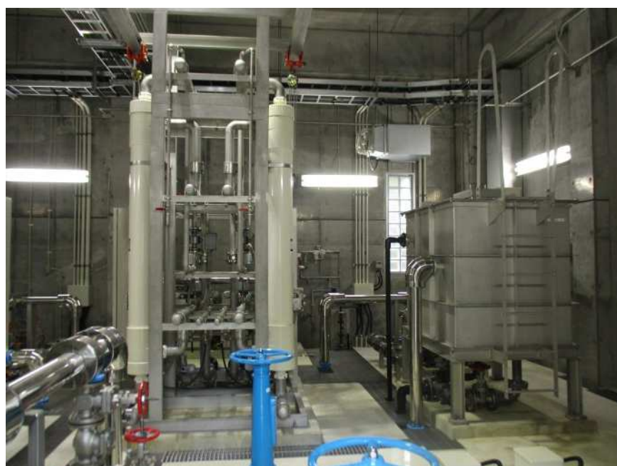
<地島浄水場の内部>
